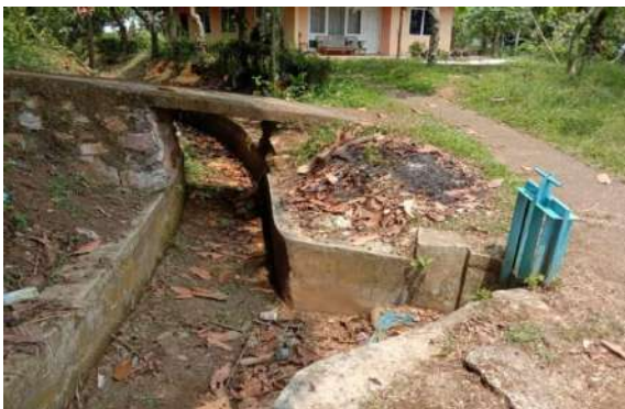
Gambar 2. Kekeringan pada Saluran Sekunder Daerah Irigasi Batang Tabik (Sumber : Observasi Balitbang Prov. Sumbar, 2023)
